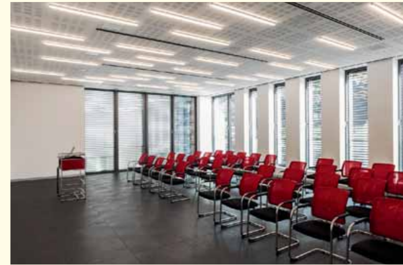
Schulungs- und Konferenzraum der Spedition. Links: das eingesetzte Lüftungsgerät VAM und das Kanalgerät FXSQ von DAIKIN Fotos: Lutz Tölle
