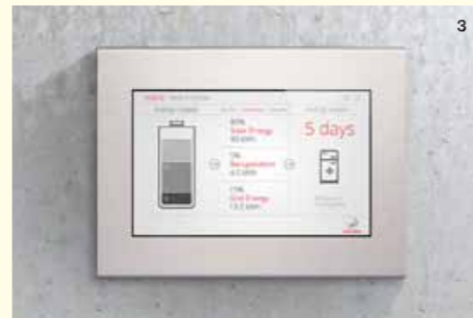
Die Pilotanlage des 3300 Solar 1 wird über PV-Module auf dem Dach 2 gespeist. Ein Display in der Fahrstuhlkabine 3 hält die Fahrgäste auf dem Laufenden
