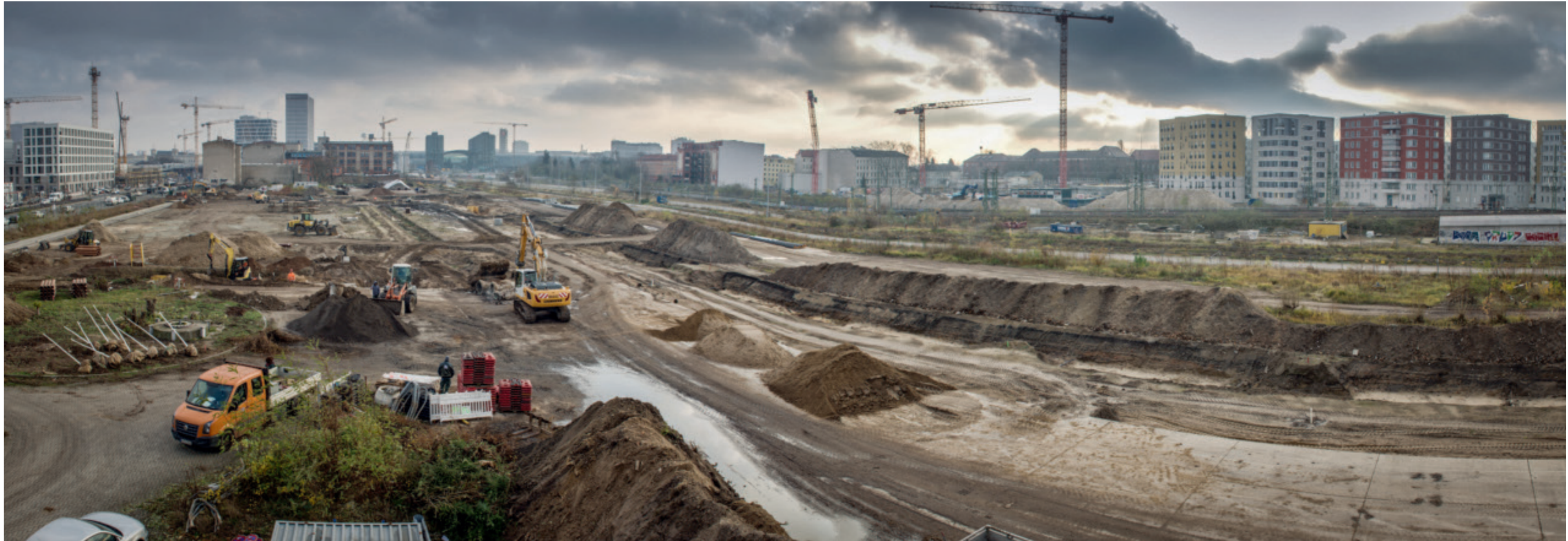
Das Quartier Heidestraße in der Berliner Europacity im Dezember 2017 (unten) und im Sommer 2021 (oben). Fotos © Quartier Heidestraße/Contempo Zeitraffer
