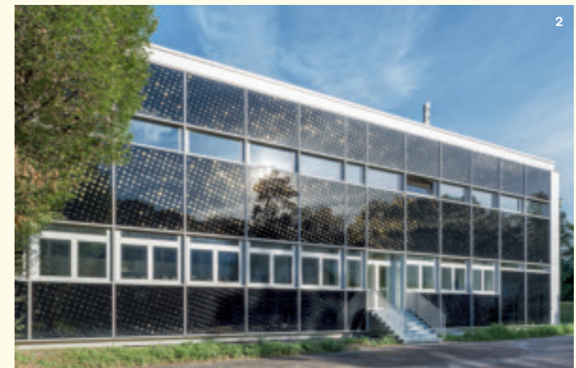
2+4 Die dunkle Glasfassade, die der Dämmung vorgehängt wurde, betont das strenge Konstruktionsraster der Siebziger-Jahre-Gebäude.
