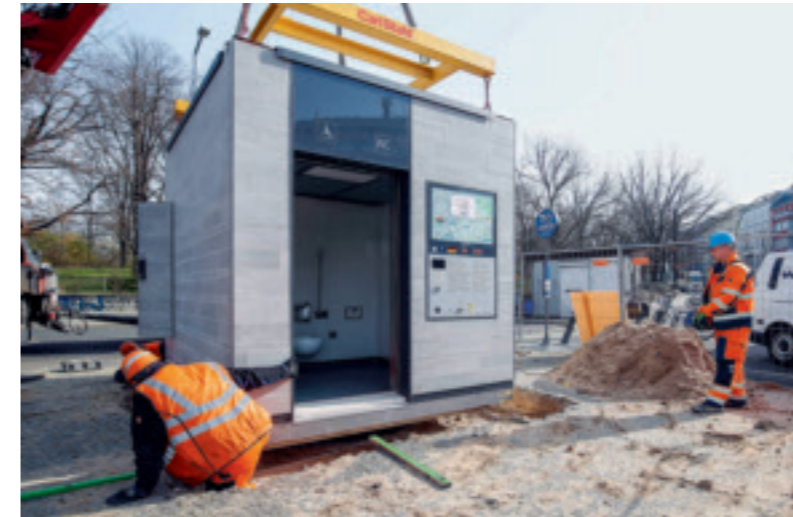
Aufstellen eines neuen WC-Containers der Wall GmbH in Berlin. Vor allem an belebten Orten wie Parks und Spielplätzen sollen die 366 Anlagen errichtet werden. Fotos: Wall GmbH
