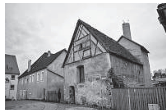
Das Gebäude stand lange leer und war in einem sehr schlechten Zustand. Der Besitzer wollte es für eine Doppelgarage abreißen. Fotos: Architekten
