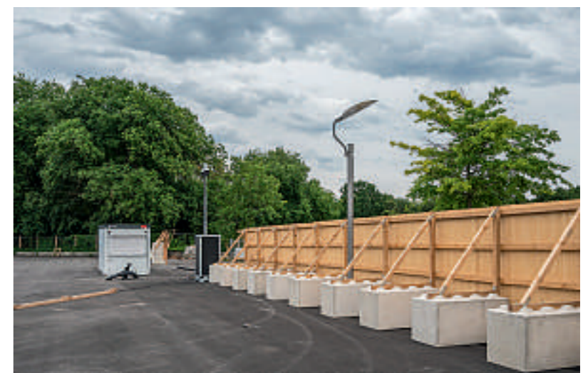
Baustelle 2. Bauabschnitt Bundeskanzleramt am westlichen Ende vom „Band des Bundes“. Im Hintergrund die in Bau befindliche Erweiterung des Bundesinnenministeriums von Müller Reimann Architekten.
