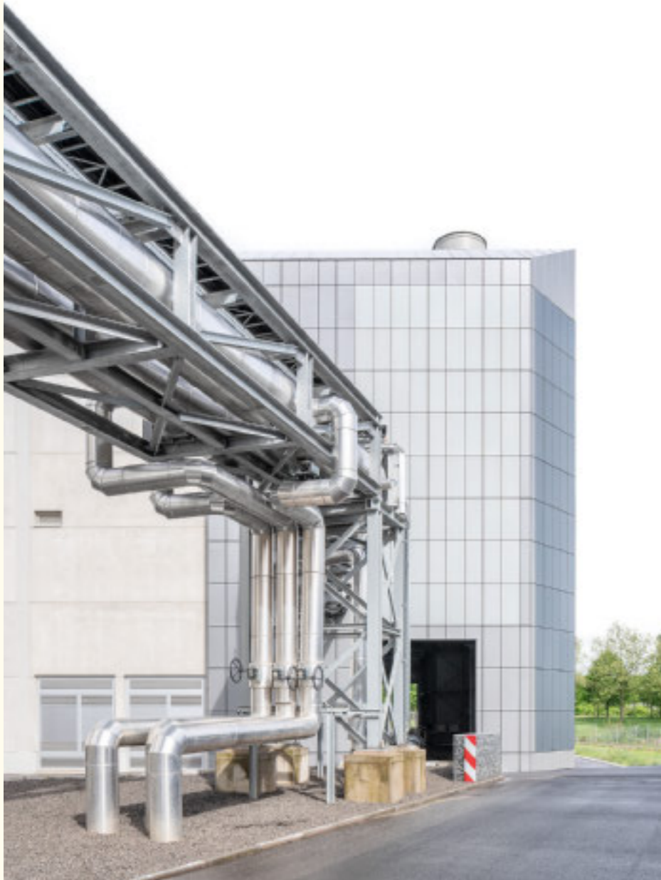
Der Eigentümer ist mit der Inbetriebnahme des Gaskraftwerks vollständig aus der Kohleverbrennung ausgestiegen. Die Gasmotoren sind für den Einsatz von Wasserstoff zur Strom- und Fernwärmeerzeugung einsatzbereit.
