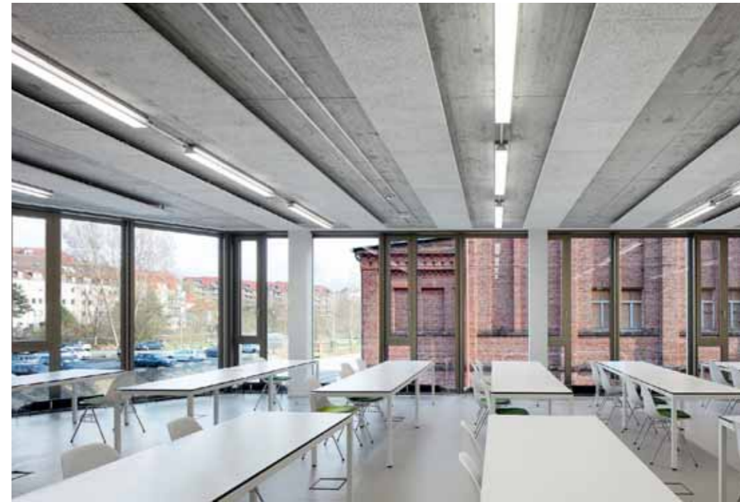
Die Deckenplatten aus Heraklit dienen der Schallabsorption und verbergen die Installationen
